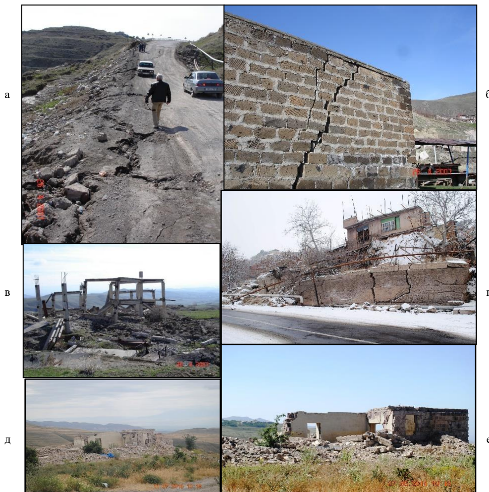
Рис. 6. Последствия смещения Вохчабердского оползня: а – деформированное полотно автомобильной дороги; б, г – трещины в стенах; в – разрушенное здание школы; д, е – развалины домов.
